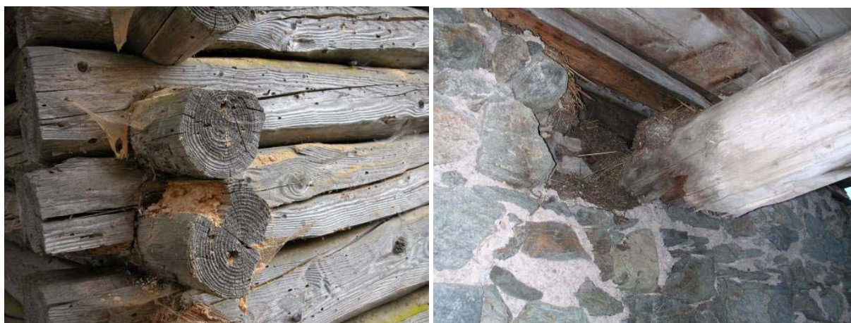
Foto 5: A sinistra: degrado dovuto ad attacchi di insetti xilofagi su un tabià in comune di Calalzo. In questo caso la modificazione locale del microclima (l'avanzamento del bosco che ha ormai circondato l'edificio) ha probabilmente favorito l'attacco. (Foto A. Turato) A destra: dissesto provocato da un degrado: L'avanzato stato di marcescenza di una trave all'appoggio sulla muratura in pietrame ne ha completamente compromesso la continuità e il comportamento statico (Foto A. Turato). La mancata manutenzione ha permesso l'accumularsi di depositi organici che hanno favorito il ristagno di umidità, che ha a sua volta provocato il degrado del legno.
