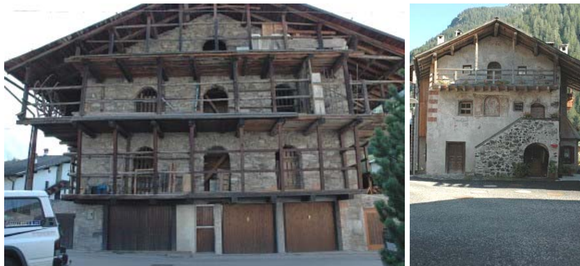
Foto 178 e 179: Canale d’Agordo e Canale d’Agordo: “Struttura” tetto ad arcarecci su costruzione in muratura.
