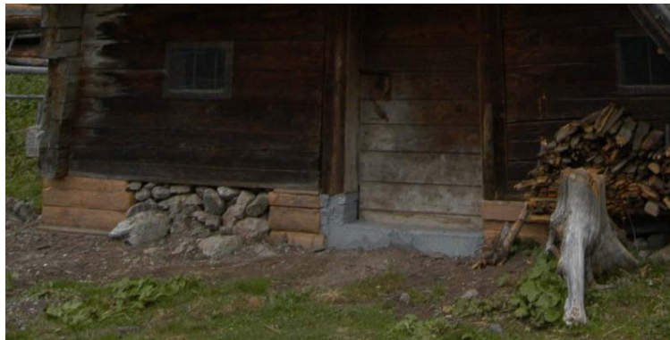
Foto 125: Costa Zucco (Val Visdende): una vecchia fondazione “a sentada” modificata con l’inserimento di materiali “moderni”.
