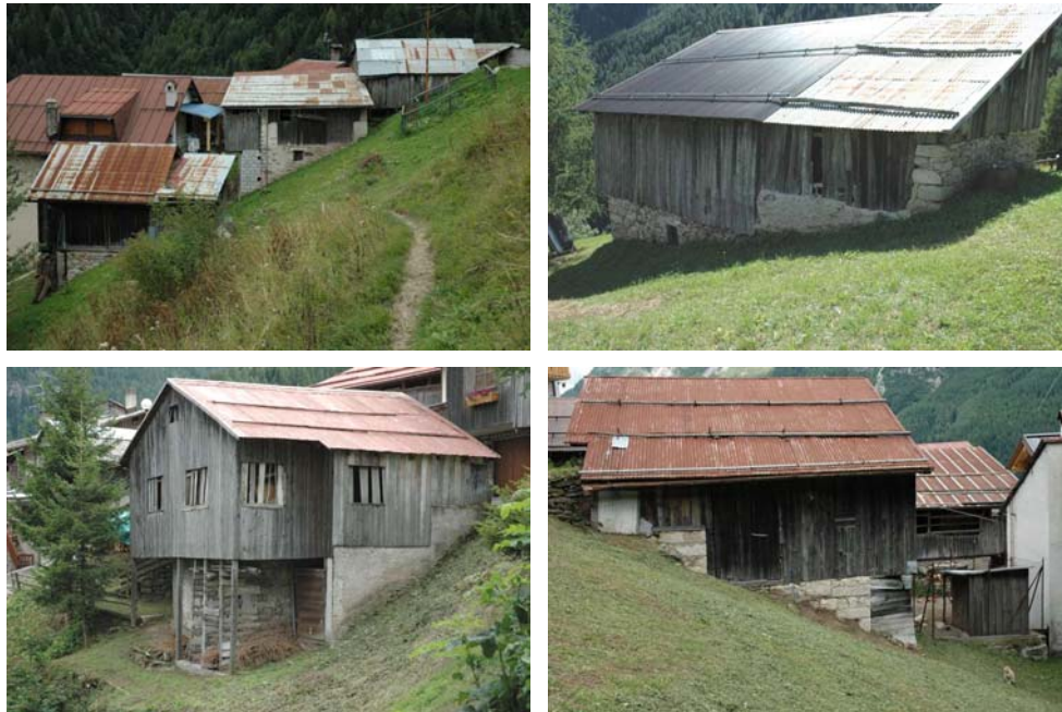
Foto 132: In ordine orario: Bogo (Cencenighe), Chioit (Cencenighe) e Martin (Cencenighe – sotto): le fondazioni a gradoni seguono lo sviluppo di murature su terreni in forte pendenza.
