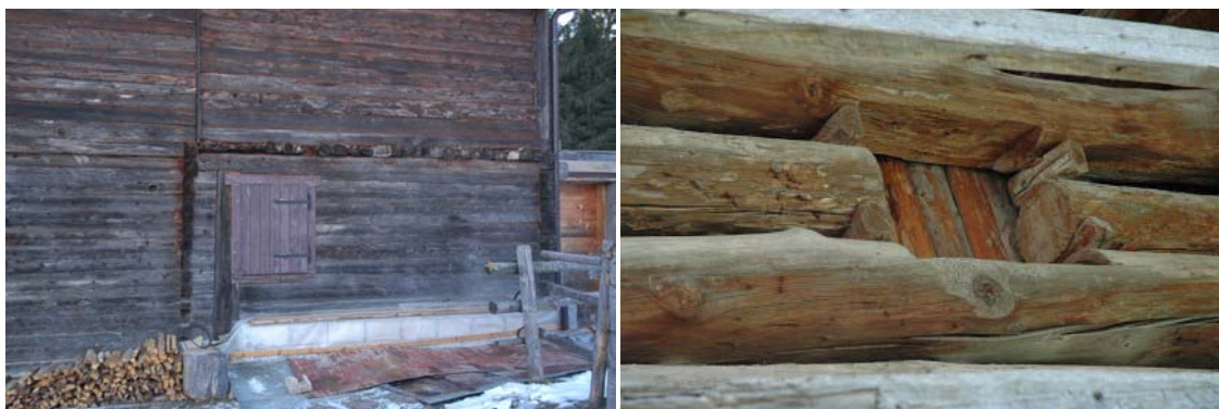
Foto 54 e 55: Prà della Fratta (Val Vissende) e Feder (Canale): l'analisi consente di comprendere la contestualità della costruzione della finestra rispetto alla costruzione della parete.
