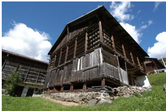
Foto 126: Costalissoio (Santo Stefano): “Sentada” in elevazione. Esempio di “struttura” “fondazione” del tipo “a sentada” complessa, in quanto sostiene il fabbricato nella parte avanzata della struttura verticale “a colonna”, consentendo di dilatare l’intero perimetro del piano terra, adibito a stalla, riducendo notevolmente l’uso della pietra come materiale “strutturale”.
