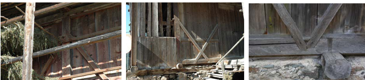
Foto 118: Feder (Canale): Esempi di sottostrutture colonna e croci di S.Andrea e colonne e controventi
