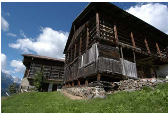
Foto 8: Muratura a secco(Costalissoio-Santo Stefano): lo zoccolo è separato dalla struttura portante dell'edificio.
