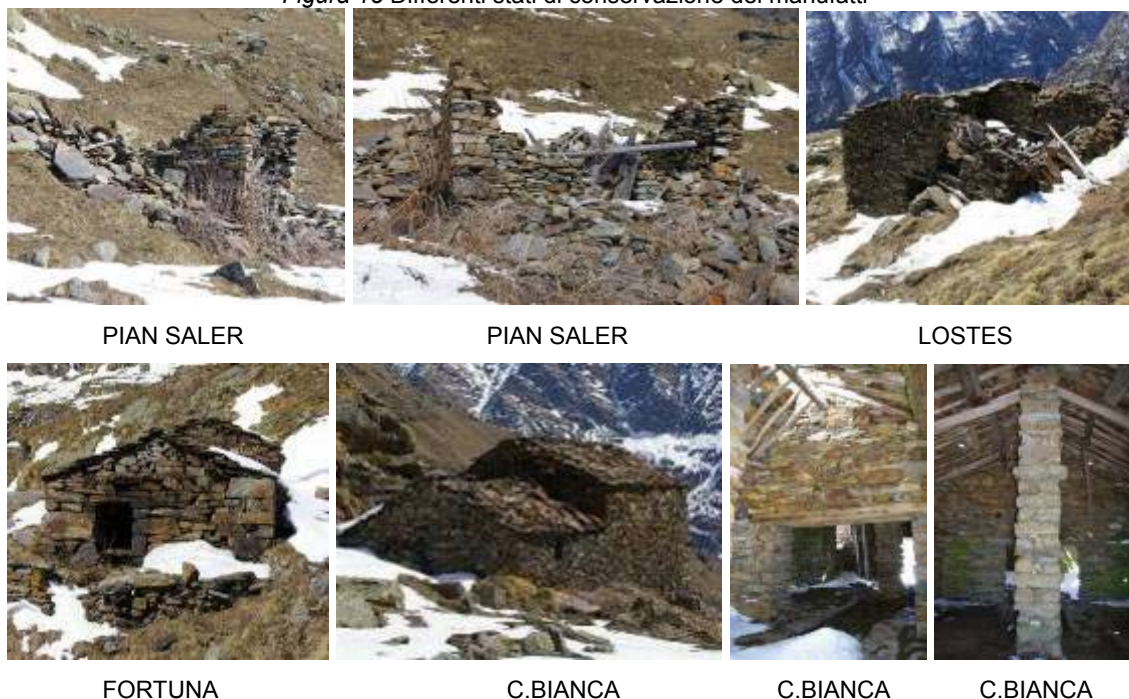
Figura 15 Differenti stati di conservazione dei manufatti
